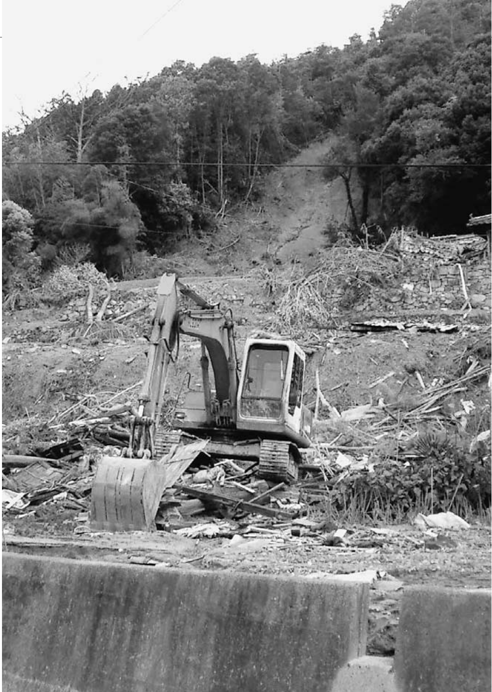
吉田町小山地区、保森日出子さん宅横の土砂崩れ。約50メートル上から崩れた土砂は、保森さん宅の前にあった空き家を丸ごと押しつぶした。
