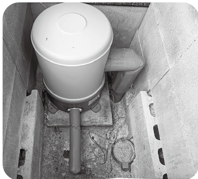
水道未普及地域で使用の井戸ポンプ
